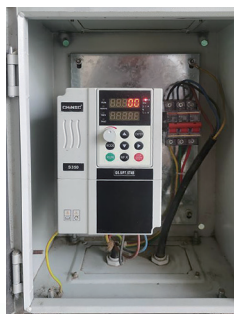
风机控制箱改造后
