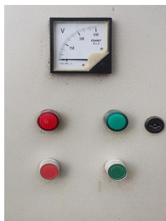
风机控制箱改造前
