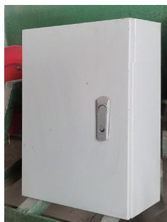
风机控制箱改造后
